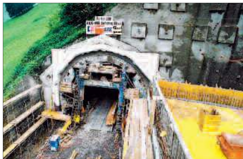
Südportal Tunnel Giswil mit Elektrozentrale.
